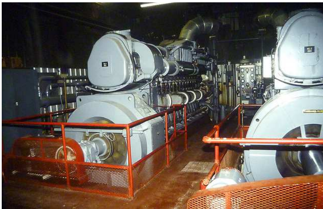
1. ábra Fairbanks-Morse dízelgenerátor telep (forrás: http://www.flickr.com/photos/55167823@N07/7199057752/ )
